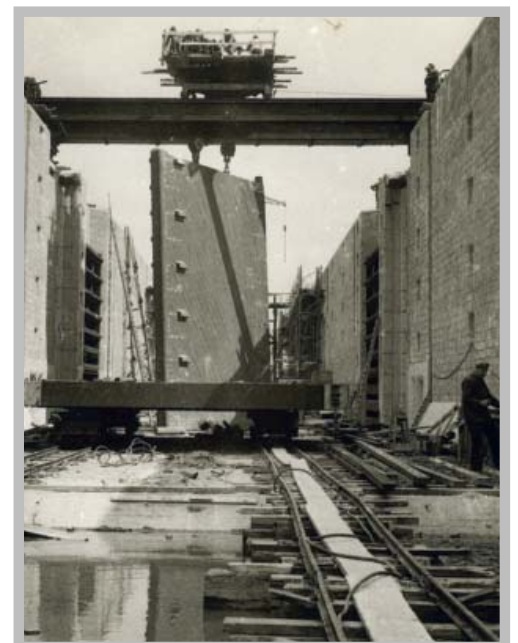
links: Zandtrein in bouwput (foto Hakeboom) rechts: Sluiskolk met muurpaneel en deur (op rails)
